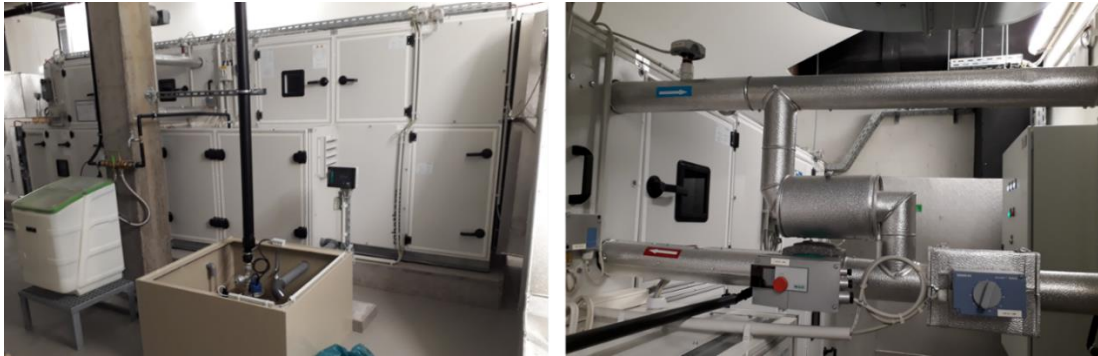
Abbildung 30: Ansicht einer RLT-Anlage im Maison du Savoir (links) und Detailfoto vom hydraulischen Anschluss des Heizregisters.
