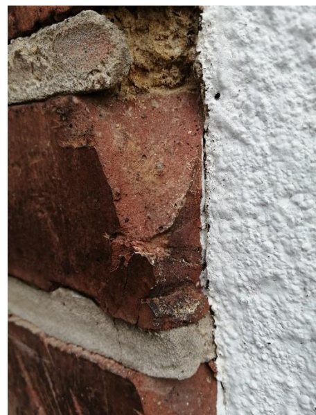
Abbildung 78: Frostscha- den an einem Ziegel und defekte Verfugung.
