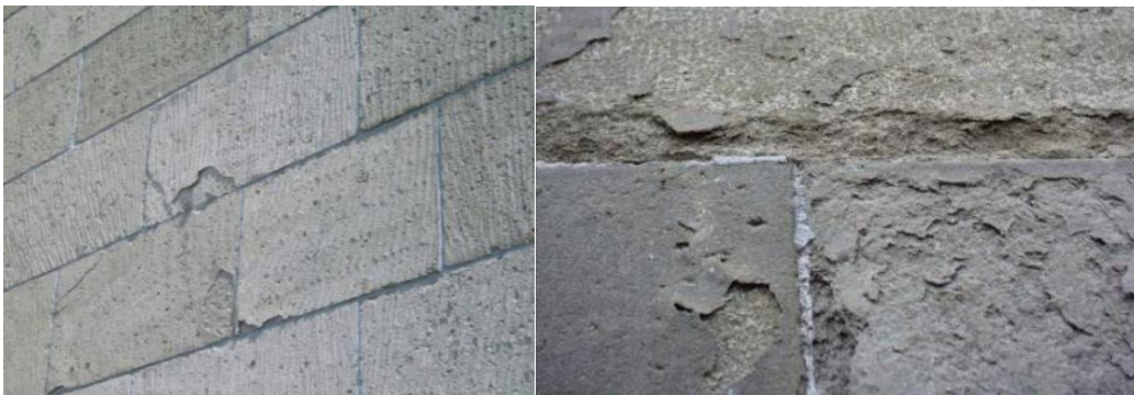
Abbildung 22: Abplatzung an der obersten Gesteinsschicht infolge einer Hydrophobierung [22]
